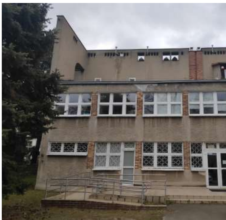
Zdjęcie nr 10: Stan elewacji frontowej budynku.
