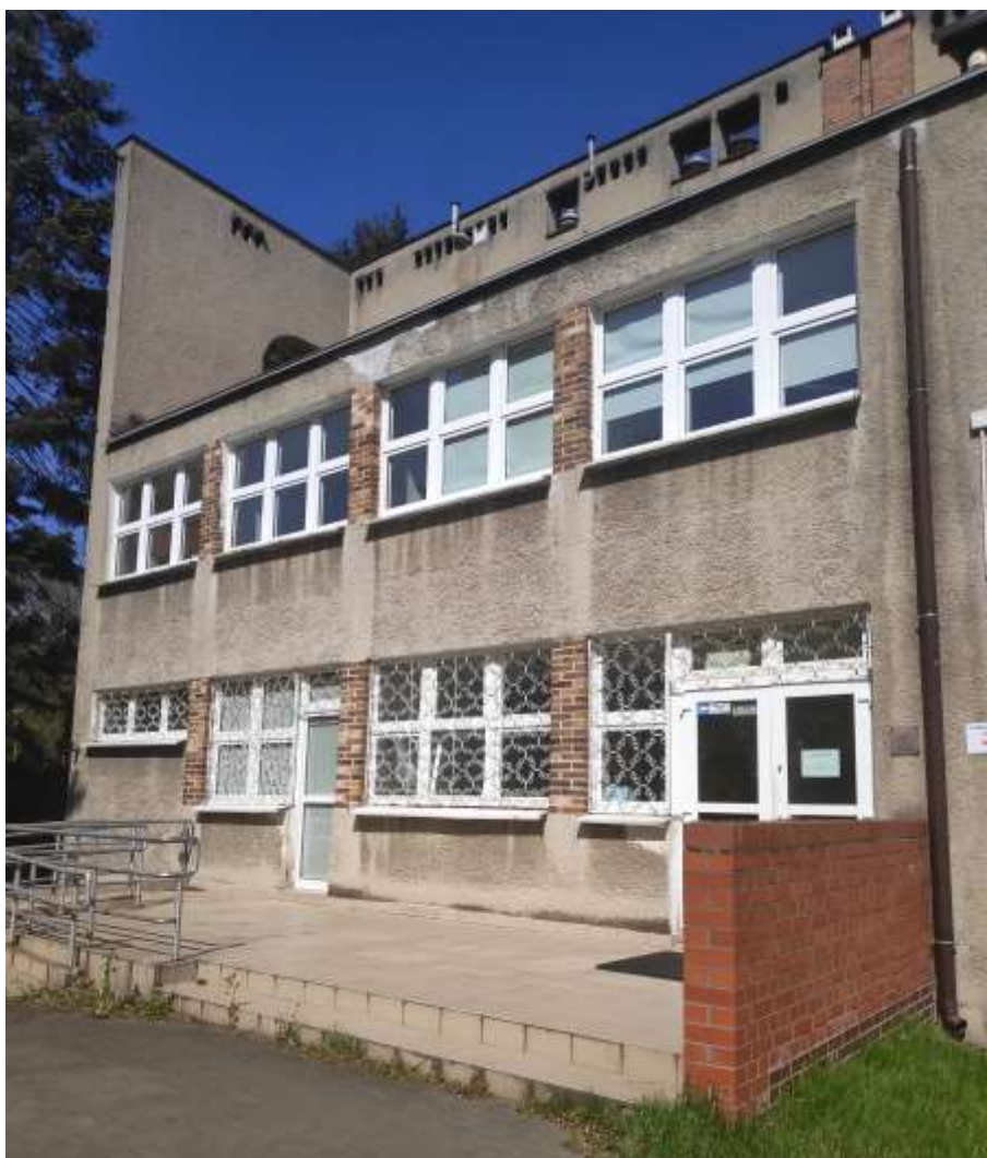
Zdjęcie nr 7: Stan tynków na ścianach zewnętrznych – zawilgocenia i zarysowania, złuszczenia lokalne na powierzchni ściany.
