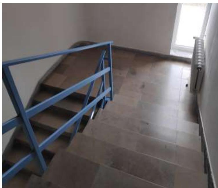
Zdjęcie nr 11: Stan techniczny klatki schodowej zadowalający.
