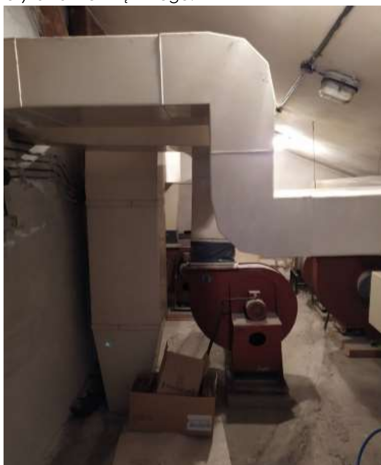
Zdjęcie nr 3: Pomieszczenie techniczne na poddaszu, gdzie znajdują się instalacje wentylacyjne nieczynne i sprężarka.
