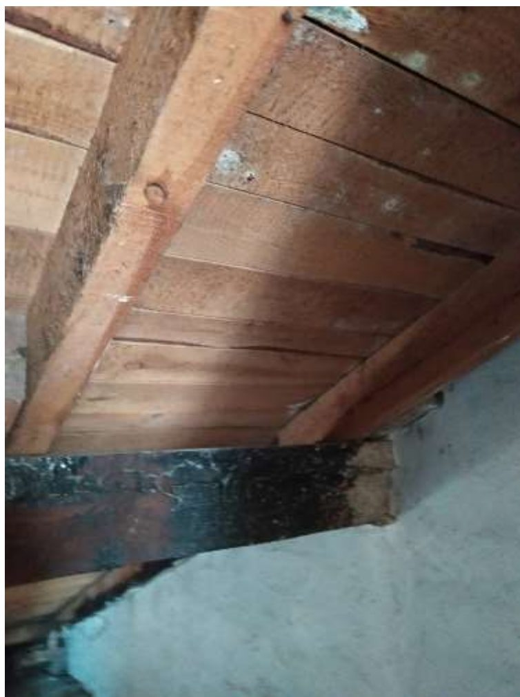
Zdjęcie nr 12: Stan techniczny więźby dachowej.
