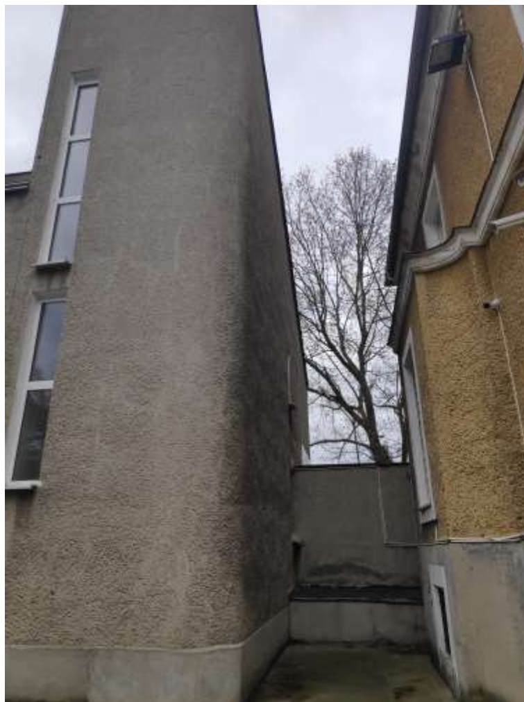
Zdjęcie nr 9: Stan elewacji od strony sąsiadującego budynku .
