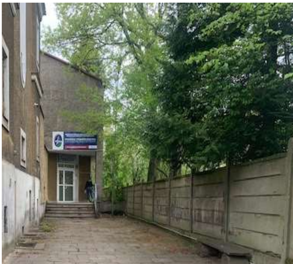
Zdjęcie nr 8: Stan elewacji frontowej budynku od strony planowanej windy.
