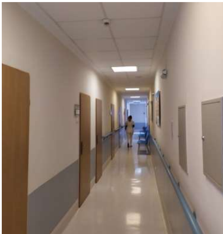
Zdjęcie nr 2: Ściany wewnętrzne i sufit budynku bez widocznych uszkodzeń. Widok korytarza wewnętrznego.
